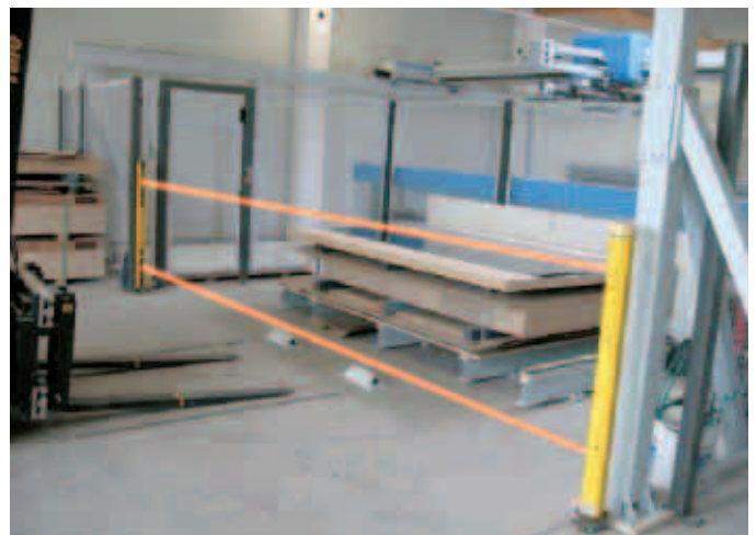
Zweistrahlige Lichtschranke als Zutrittsicherung zwischen Umgebungsbereich und Übergabeplatz
